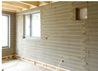
Lehmwand mit Wandheizung
