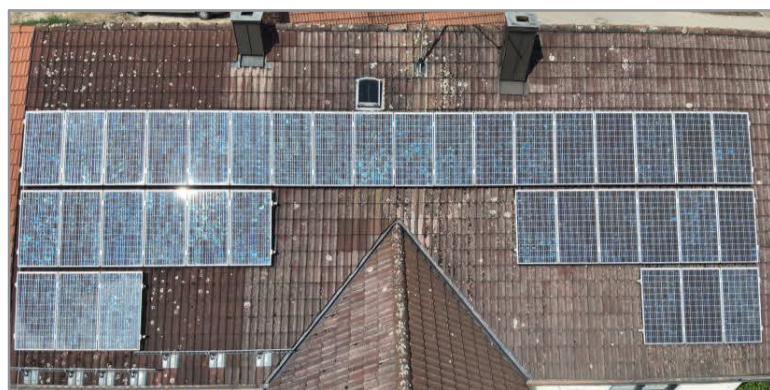
Überflug über Photovoltaikanlage Standardansicht Weitwinkelkamera der Drohne
